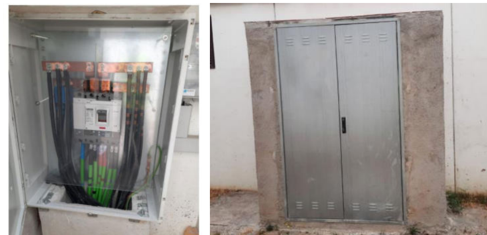
Figura 15: Armari amb el punt de connexió de la FASE 1
